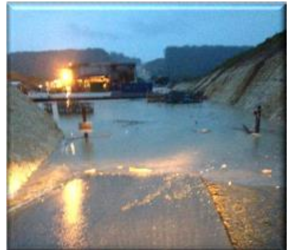
Photo 215 : Inondation de la culée C6 du viaduc de l'Austreberthe en mai 2014
