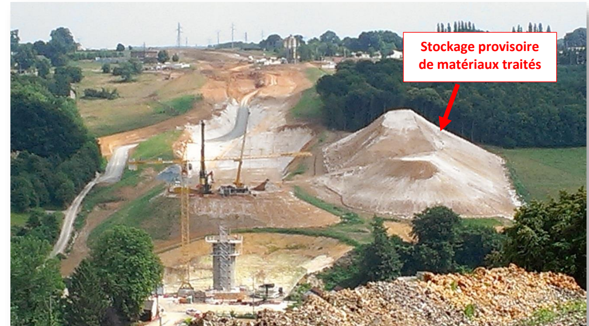
Photo 206 : Stocks provisoires à l'intérieur des emprises des futurs bassins de traitement.
