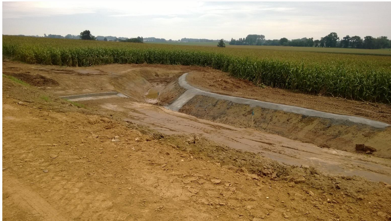
Photo 220 : Exemple de lame de diffusion avec seuil béton – Aval OHA8922 au PR19.76 (Bouville) (Photo ALBEA – octobre 2013)
