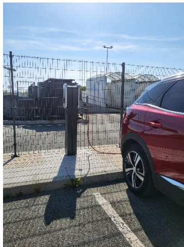
Figure 17 : Bornes de recharge électrique
