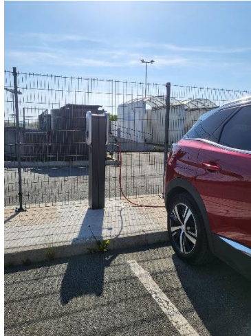
Figure 22 : Bornes de recharge électrique
